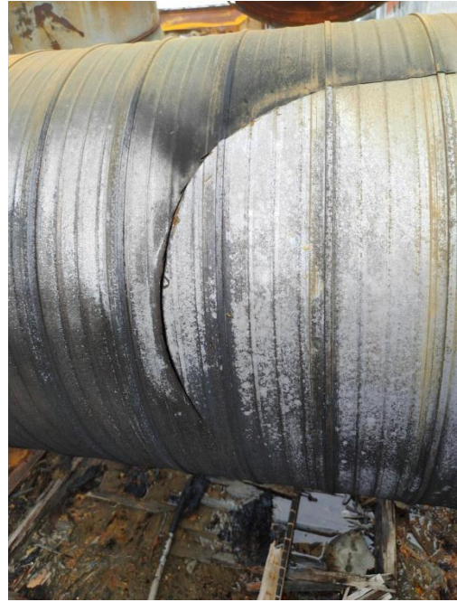
图 4 主管道上切割痕迹
