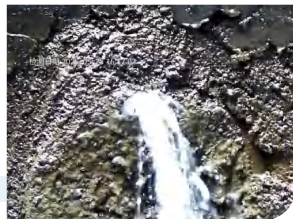
管道壁渗漏污水
